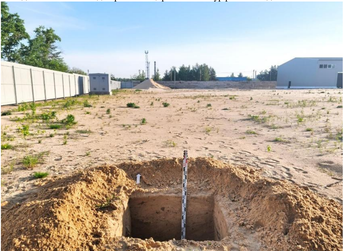
Рис. 34. Объект: земельный участок с кадастровым номером 52:21:0000114:10874 расположенный по адресу: Нижегородская обл., г. Дзержинск, Заревская объездная дорога, в районе д. 9Г. Общий вид на рекогносцировочный шурф №3. Вид с Ю.
